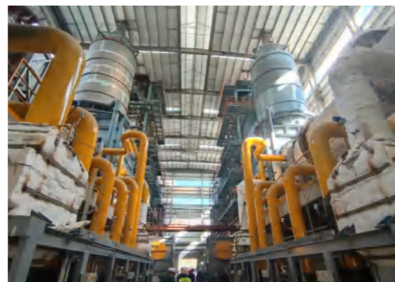
医废焚烧处置设备
